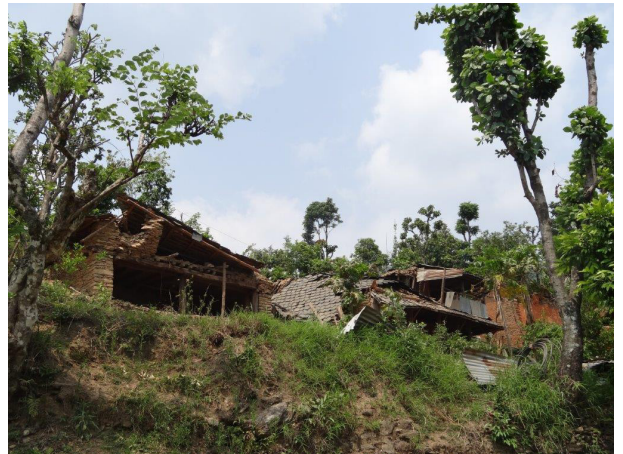
Erdbebenschäden in Dhuwakot
