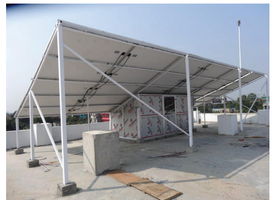
Solaranlage auf dem Neubau
